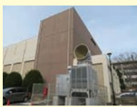
屋外の冷温水発生機
